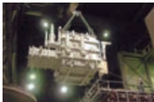
(更新した変圧器)
