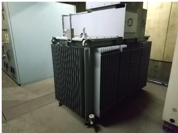
高効率変圧器への更新（本社工場）
