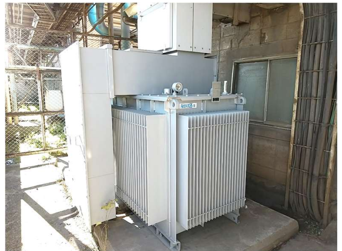
高効率な変圧器へ更新
