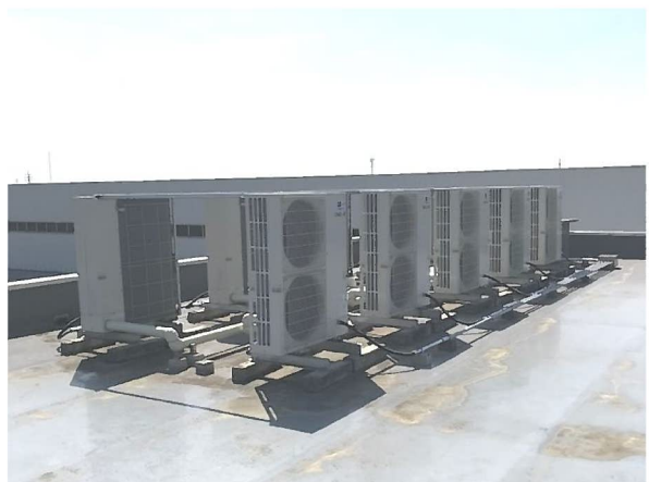
空気調和機 (室外機)
