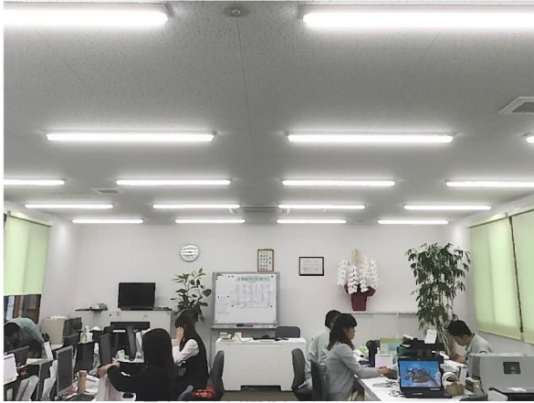
物流事務棟 照明(LED)
