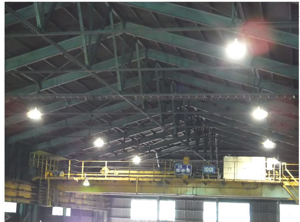
製品倉庫 照明(LED)
