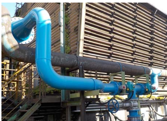
高効率な給水ポンプの設置
