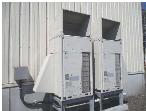
空調設備の更新
