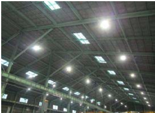
▲製品倉庫（照明の LED 化）
